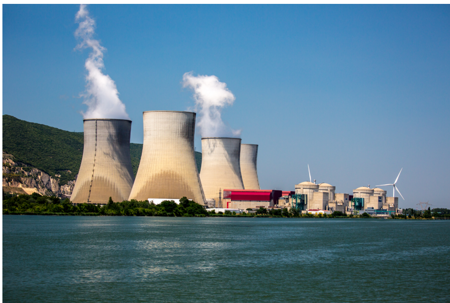
Wieże chłodnicze, część kompleksu elektrowni jądrowej wzdłuż rzeki Rodan w pobliżu Meysse i Cruas, Francja. Źródło: Adobe Stock.
